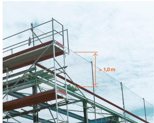
1 Vorgespanntes Drahtseil anstelle eines Geländerholms: Ein Absturz zwischen Dachrandträger und Auffangnetz hindurch muss verhindert werden. Die Netz-Oberkante liegt 1,0 m über der fertig erstellten Standfläche.
