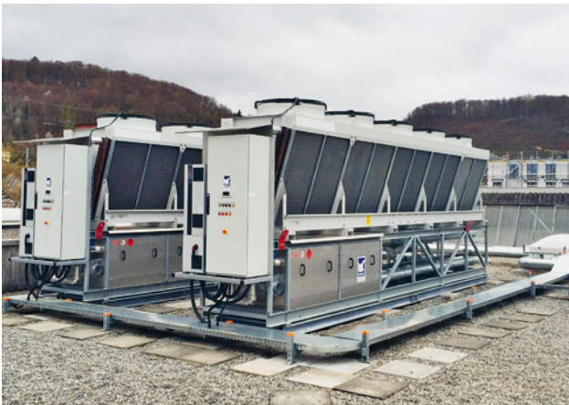
Kälteanlage im Freien.
