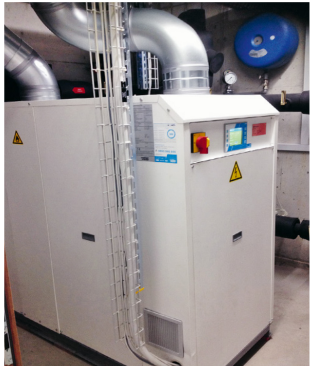
Kälteanlage in belüftetem Gehäuse.
