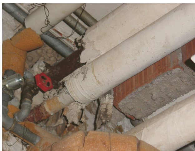
1 Isolation de tuyau avec mortier amianté.
