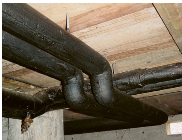
2 Isolation de tuyau avec revêtement bitumeux amianté.
