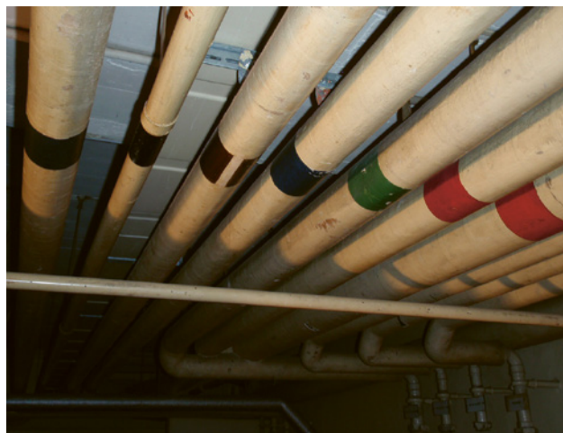
1 Rohrisolation mit asbesthaltiger Gipsbandage
