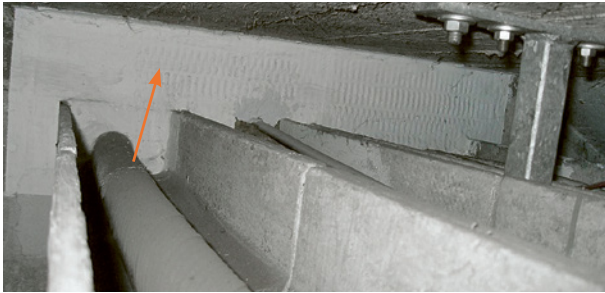
Kabeldurchbruch mit Brandabschottung
