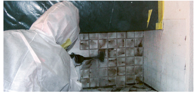
Entfernen nur durch anerkanntes Asbestsanierungsunternehmen
