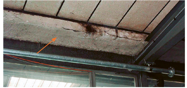
Spritzasbestisolation an Dachkonstruktion
