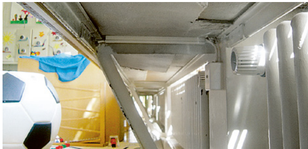
Leichtbauplatte unter Fenstersims...
