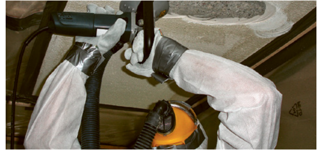
Entfernen nur durch anerkanntes Asbestsanierungsunternehmen
