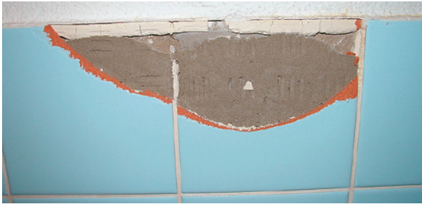
< 1 % Chrysotil-Asbest im Kleber
