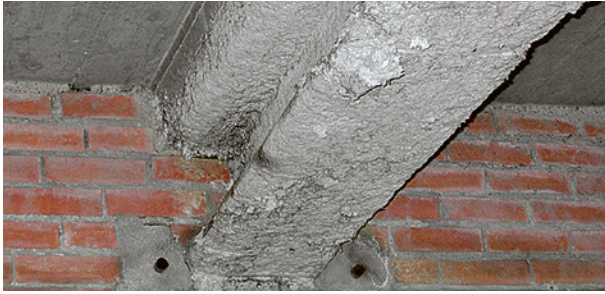
Spritzasbest an Stahlträger
