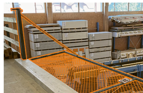
5 Zone de (dé)chargement avec grillage de retenue rabattable
