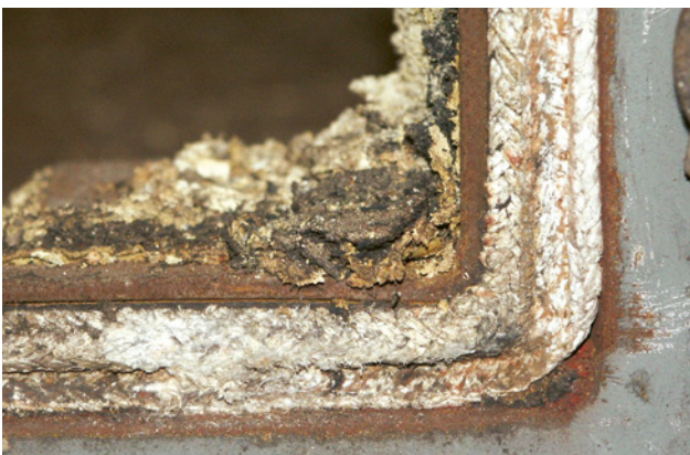
10 Vorsicht: Asbestmatten als Isolation und Asbestschnüre als Abdichtung von Türen an Feuerungsanlagen.
