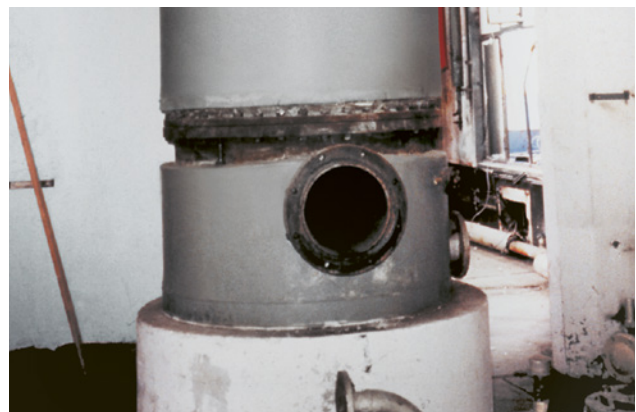
11 Asbesthaltiges Isolationsmaterial an Heizkesseln ist häufig abgedeckt, z. B. durch Blech.
