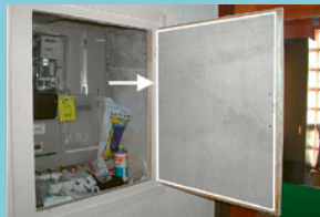
Panneau de protection incendie
