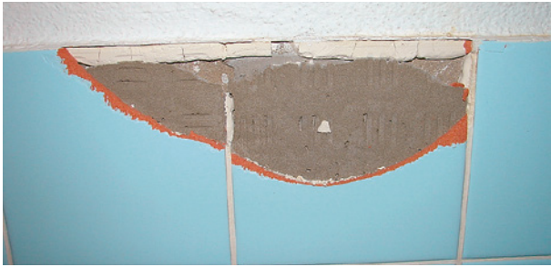
Colle contenant < 1 % d'amiante chrysotile
