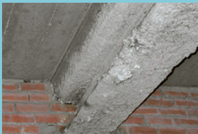
Isolation en amiante floqué
