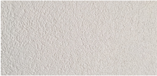
Crépi acoustique amianté
