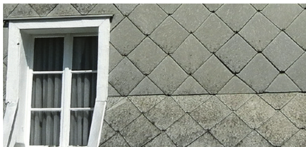
Pannelli per facciate contenenti amianto
