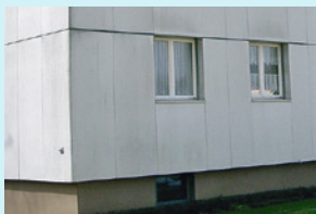
Pannelli per facciate contenenti amianto
