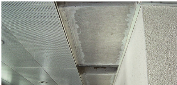
Pannelli per soffitti contenenti amianto
