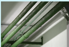
Vernici contenenti amianto
