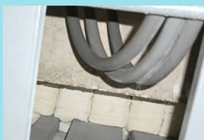
Sigillature antincendio con cuscini di amianto
