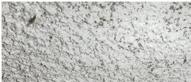
Intonaco acustico contenente amianto
