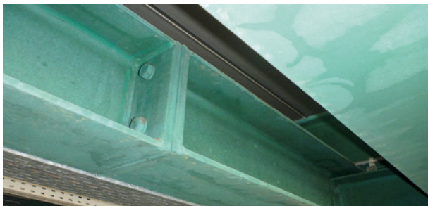
Vernici contenenti amianto
