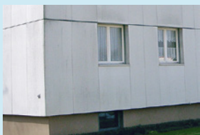
Pannelli per facciate contenenti amianto
