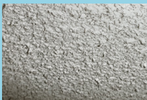
Intonaco contenente amianto
