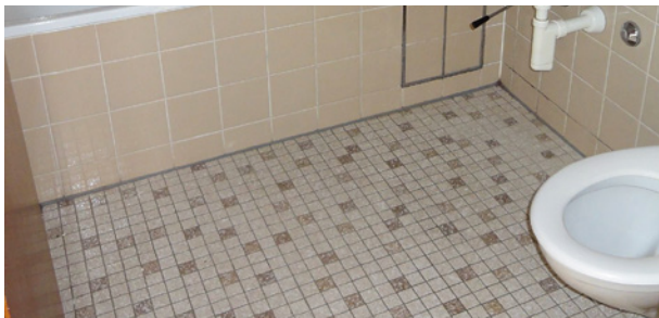
Piastrelle per pavimenti e pareti con colla contenente amianto
