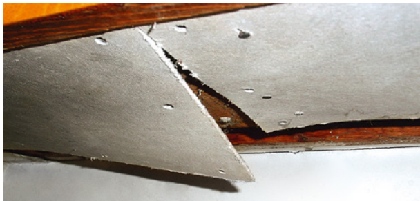
Pannelli leggeri contenenti amianto
