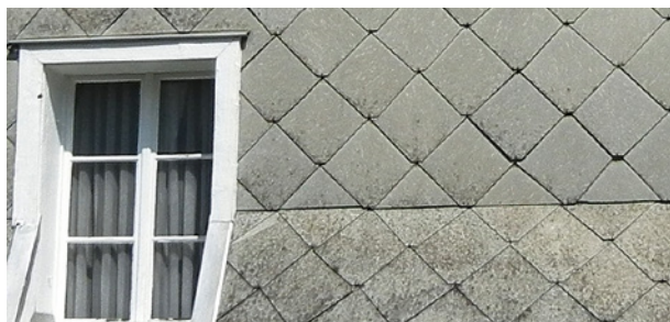
Pannelli per facciate contenenti amianto
