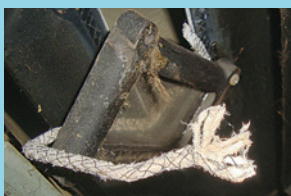
Corde di amianto
