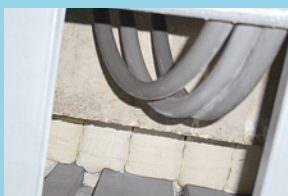
Sigillature antincendio con cuscini di amianto
