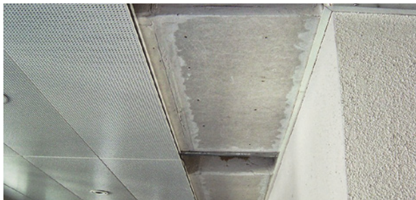
Pannelli per soffitti contenenti amianto
