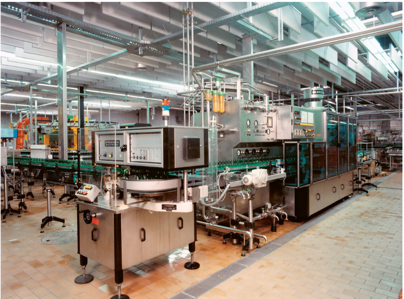
16 Baffeln aus Steinwolle-Akustikplatten in einer Getränkefirma (Abfüllanlagen).
