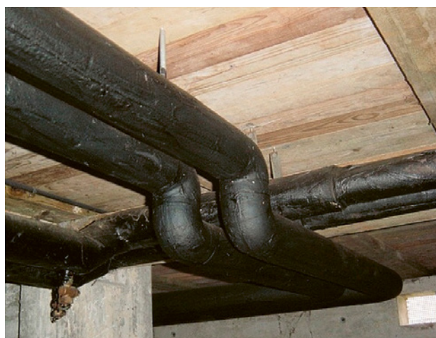
2 Rohrisolation mit asbesthaltigem Bitumenanstrich
