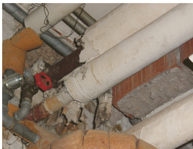
1 Rohrisolation mit asbesthaltigem Mörtel
