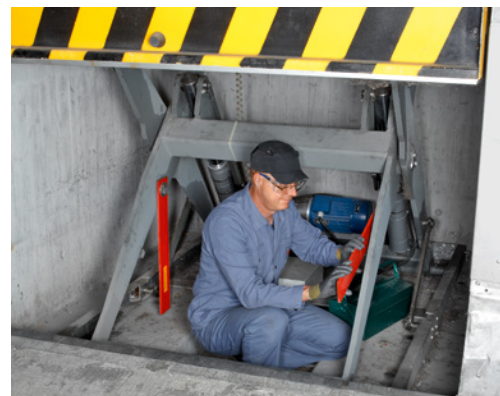
8 Bei ausgefahrenen Stützen ist das Instandhaltungspersonal gegen ein unbeabsichtigtes Absenken der Hebebühne geschützt.
