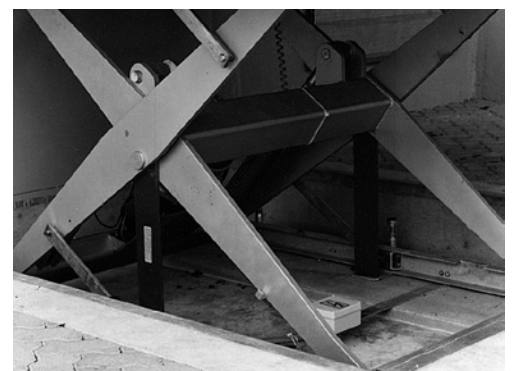
9 Bei ausgefahrenen Stützen ist das Instandhaltungspersonal gegen ein unbeabsichtigtes Absenken der Hebebühne geschützt.
