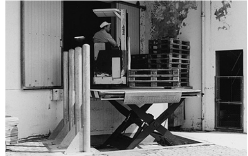
2 Diese Pfeiler wurden installiert, nachdem ein Staplerfahrer mit seinem Gabelstapler von der Hebebühne gestürzt war.
