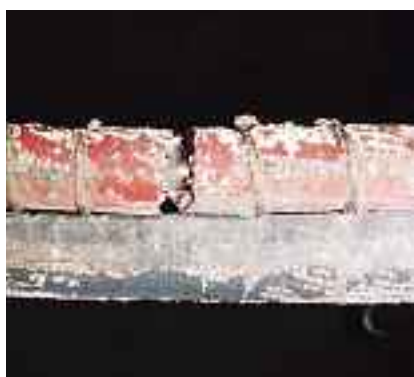
Bild 6: Defekte Schweissanlage, entdeckt bei einer Inspektion.
