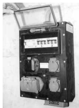
Fig. 2: distributeur de courant avec disjoncteur à courant de défaut (disjoncteur FI). Ce dernier doit être utilisé pour les installations employées à l'extérieur.
