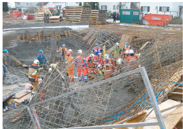
6 Die Deckenschalung (inkl. Bewehrung) ist eingestürzt aufgrund exzentrischer Krafteinleitung.
