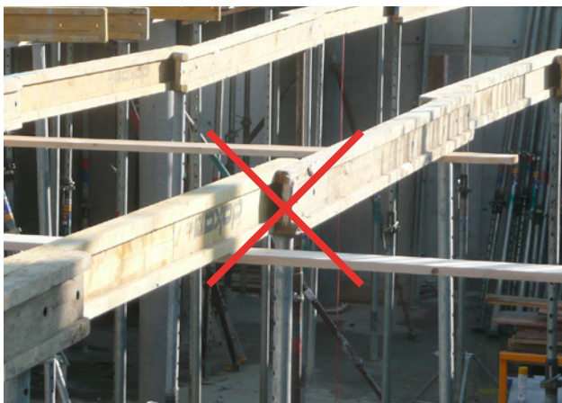
5 Spriessung für vorfabrizierte Betonelemente: mangelhafte Stabilisierung, schräg gestellte Deckenspresse, fehlende Vierwegköpfe
