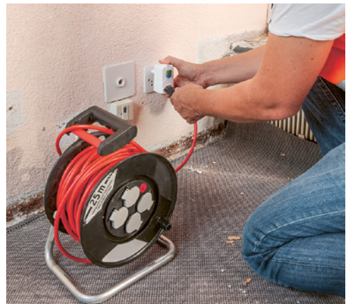
4 Kabelrolle über mobile Fehlerstrom-Schutzeinrichtung (FI-Schutz/RCD) betreiben.
