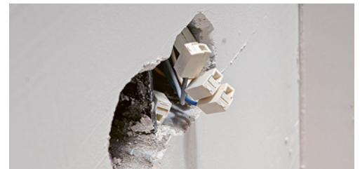
8 Aus der Wand herausragende, isolierte Drähte.
