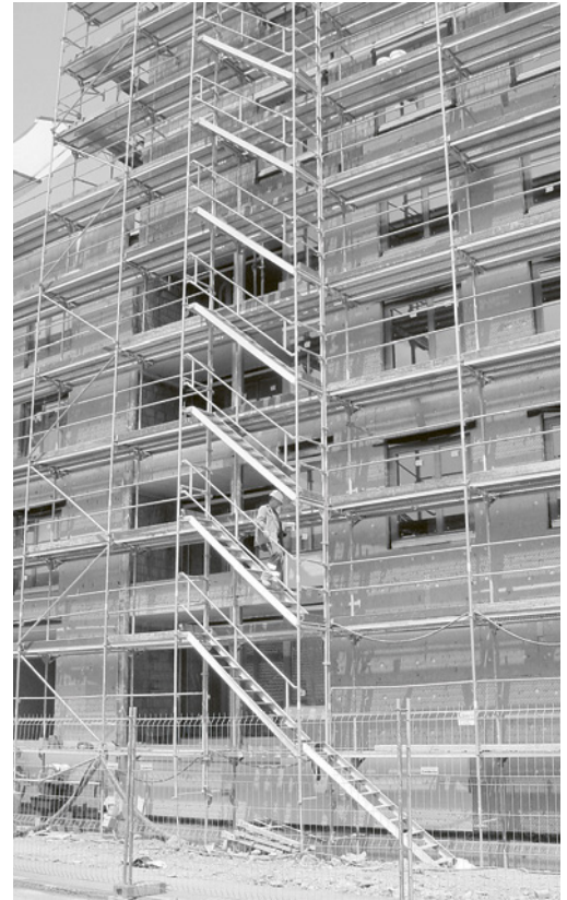
1 Treppen ermöglichen einen sicheren Zugang zu jedem Arbeitsplatz auf dem Gerüst.
